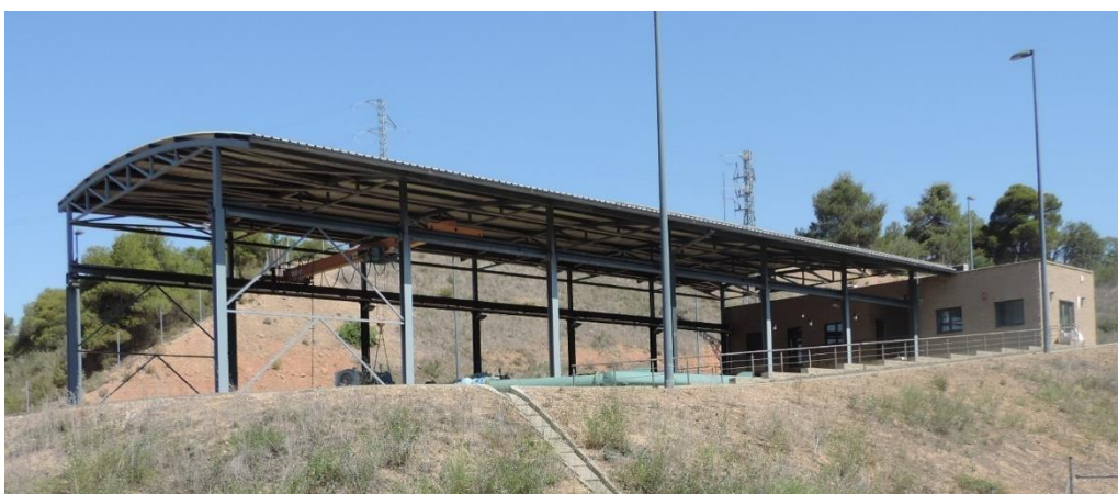
Foto 16. Estació de bombeig de Bellaguarda.
