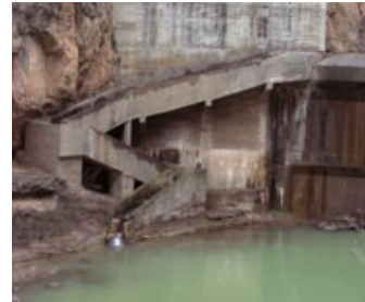
Figura 27. Dispositiu de pas per a peixos de safareigs successius amb salts que té l'entrada inferior amb un desnivell massa alt i salts excessius entre els safareigs. El Segre a la central d'Alòs de Balaguer a Camarasa, la Noguera. Fotos: Marc Ordeix-CERM.
