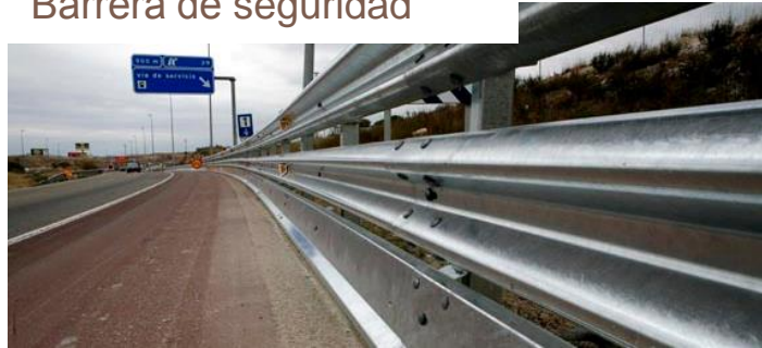
⊕ “Barrera de seguridad”
