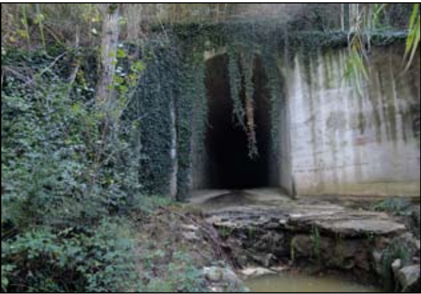
Boca sud, a tocar del riu Anoia, del llarg pas subterrani del torrent del Salt del Llop, amb greus obstacles al desplaçament de la fauna.
