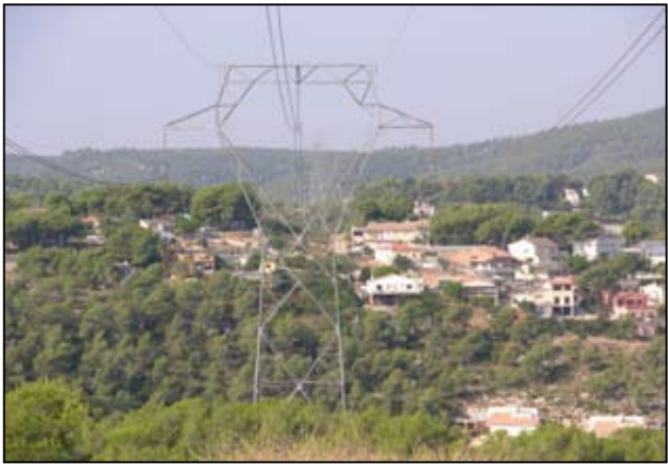
Torre d'alta tensió travessant la urbanització del Mirador de Sitges.
