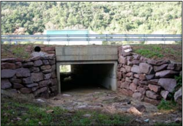
Torrent de l'Artiga, que en el darrer tram fins assolir al riu Congost en un pas soterrat per sota la C17 clarament millorable per a la connectivitat.
