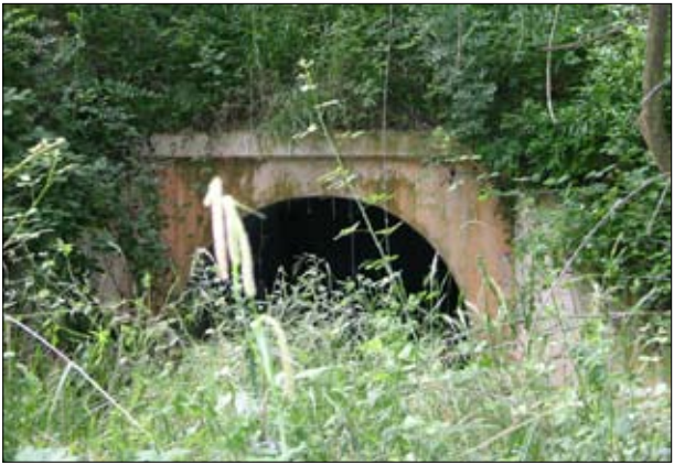
Pas insuficient del torrent de la Font del Pont sota el vial d'accés a la urbanització Can Pallars i Llobateres.
