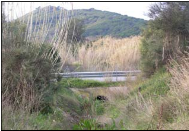
Pas clarament insuficient del torrent de l'esquerra de Madà per sota la C-32.
