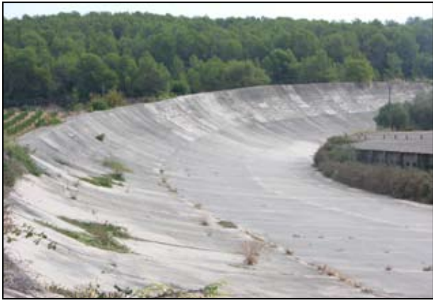
Autòdrom de Terramar, actualment en estat d'abandonament.
