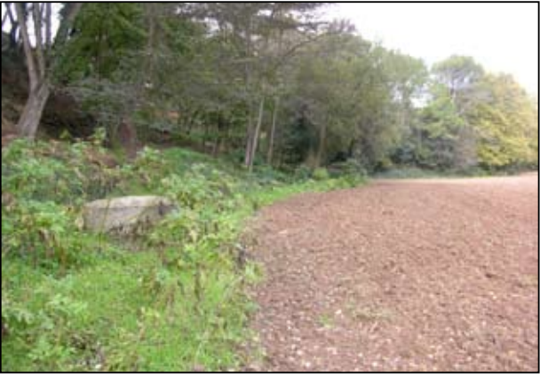
Torrent de les Valls, entre les urbanitzacions de Can Falguera i can Rovira, afectat per obres de canalització d'aigües residuals.
