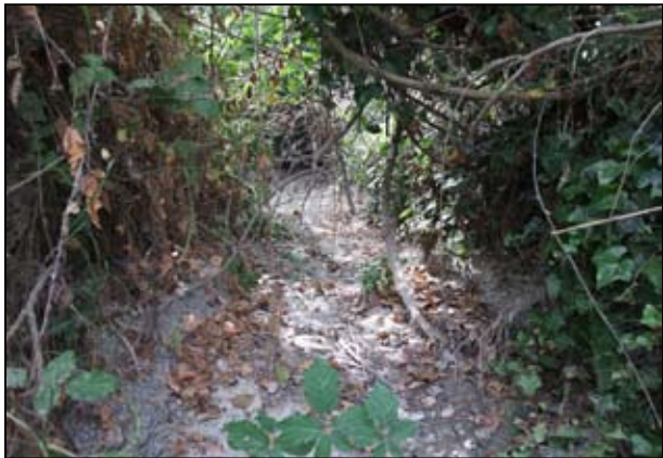
Pas sota la carretera BV-5001 en el torrent de can Torrents, clarament inadequat per a la connectivitat de la fauna.
