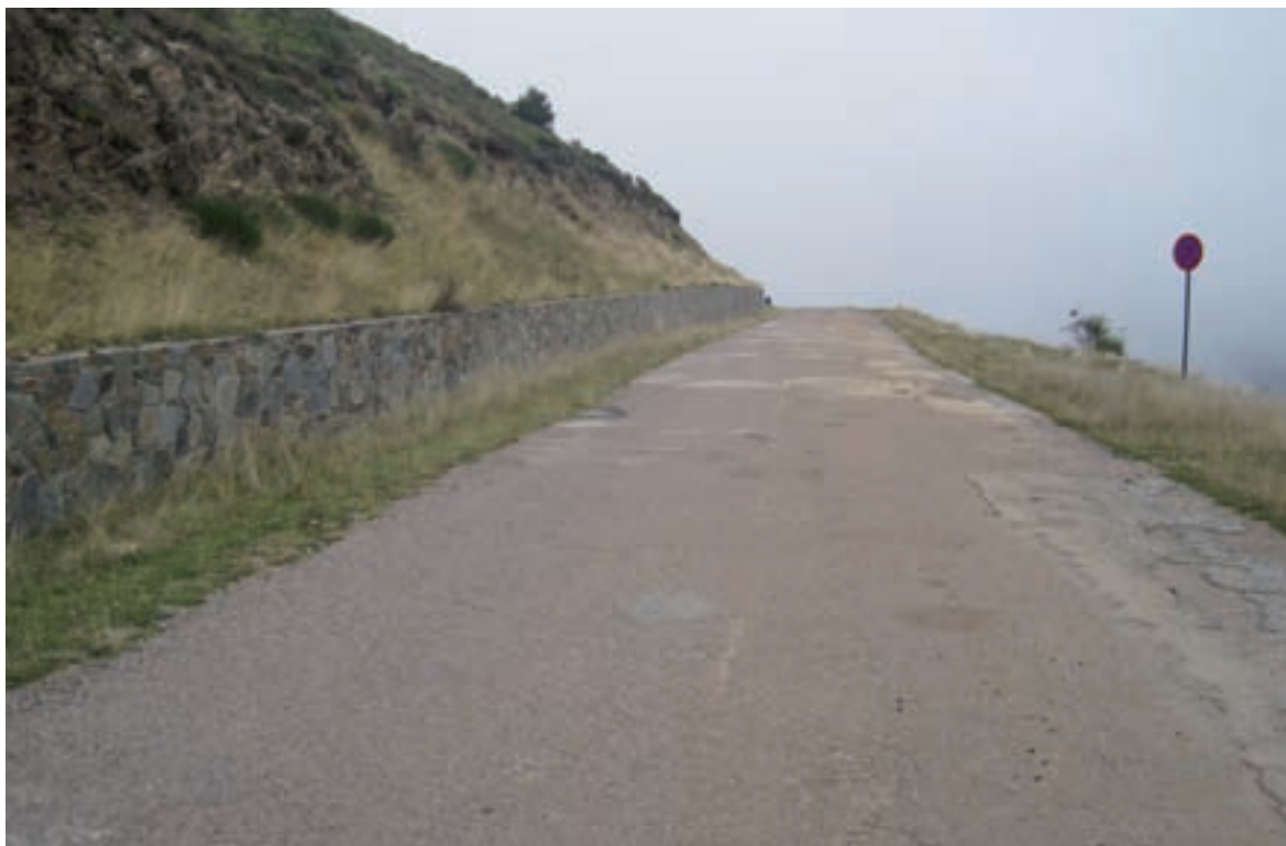
Imatge 3.8 Fissures longitudinals en el paviment típic en zones amb risc de gelades - © DTES
