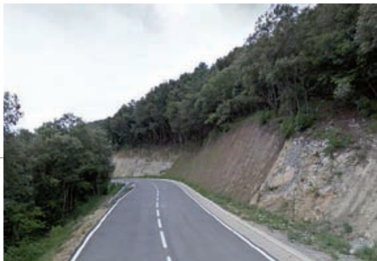
Imatge 5.1 Talús excessivament vertical que no permet la revegetació © CICSA
